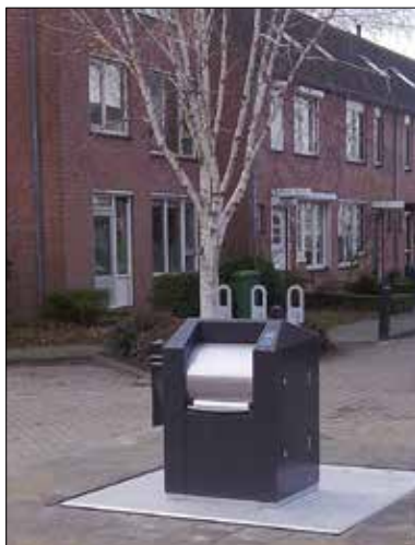
L'un des 2 compacteurs enterrés dans la commune de Made-Drimmelen (NL).
