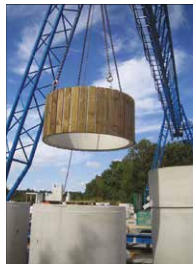
Dans l'usine de béton, les deux parties du silo sont déjà jointes.
