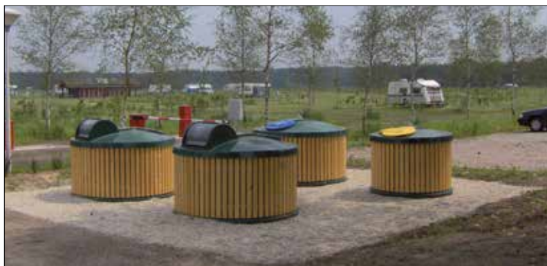
Combinaison d'un tambour pour déchets résiduels avec sécurité enfants et d'une trappe verrouillable dans un camping à Wolfsheze.
